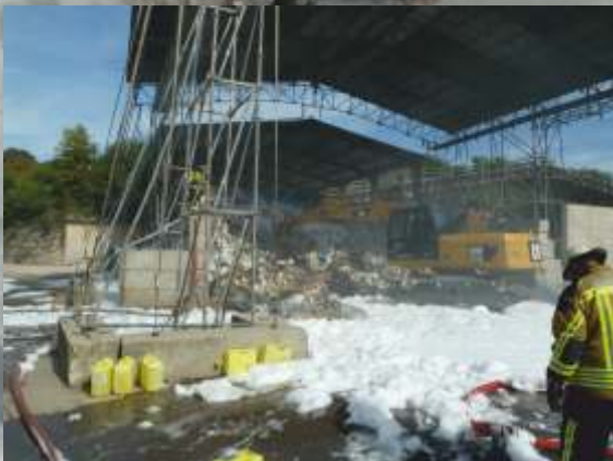
28. September 2014 | 14:12 Uhr Brennender Schutthaufen mit Bauabfällen Abteilung Maleck-Windenreute und Kollmarsreute im Einsatz Da es über eine Stunde dauert bis ein geeigneter Bagger verfügbar war, wurde der Schutthaufen mit Schaum abgedeckt.
